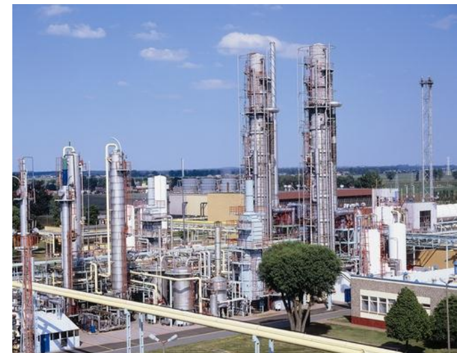
Zakład odazotowania gazu KRIO Odolanów
